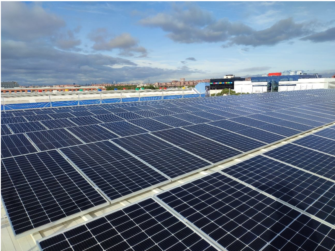
Vista general Campo Fotovoltaico
